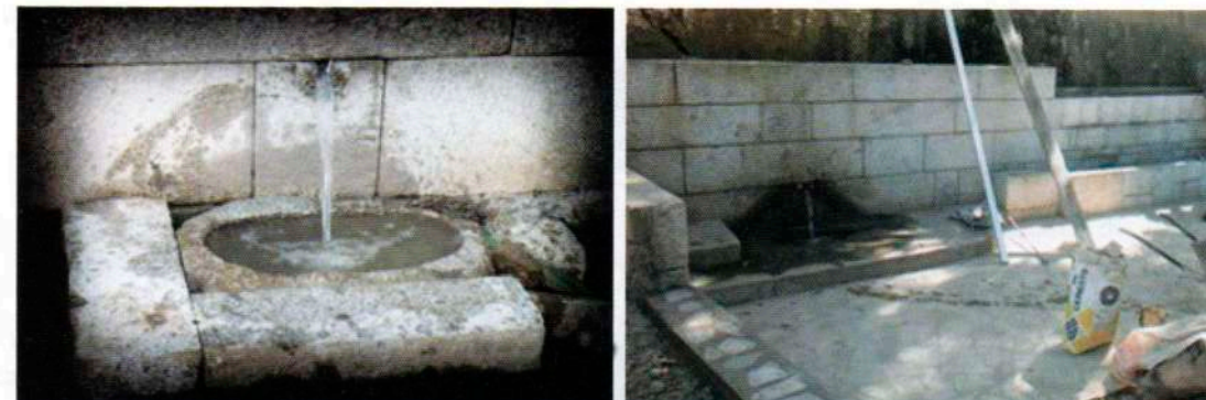
La nueva estructura lítica es el resultado de la iniciativa de un trabajo coordinado.
