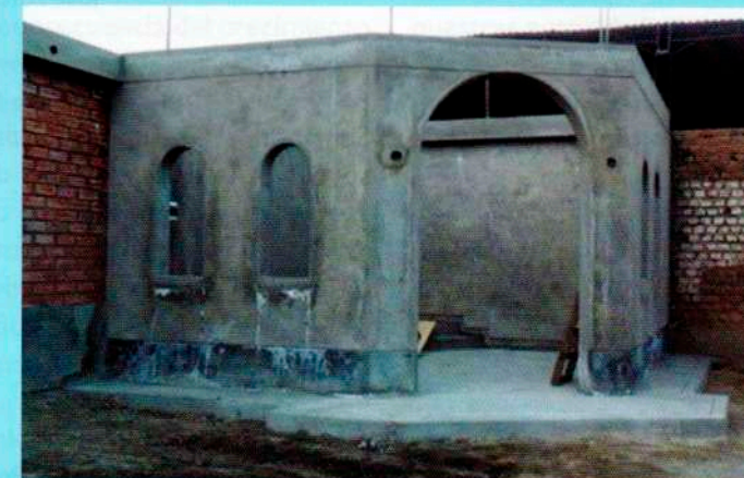
La capilla de Mama Ashu, en actual construcción en el local institucional.
