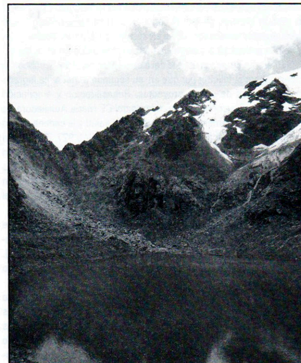
Como se puede ver, las acumulaciones de desmonte rocoso, consecuencia de los trabajos en la carretera, alteran el diáfano paisaje cordillerano. INRENA ha dispuesto que en trabajos posteriores se transporte las rocas hacia botaderos especialmente acondicionados.
