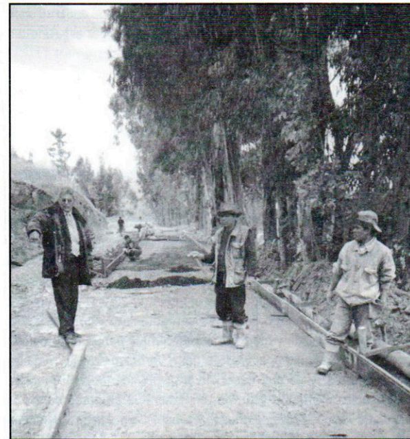
En toda obra pública, como en la pavimentación de la avenida Buenos Aires, debe exhibirse, por ley, un cartel que indique: Nombre del proyecto, valorización, origen del financiamiento, plazo y responsable de la ejecución, entre otros datos. Ojalá ya se haya subsanado tal omisión. Aportar con sugerencias no significa oposición.
