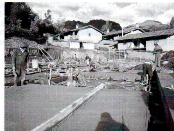
Corresponde a los trabajos de la losa multideportiva en Chacas, barrio de Camchas.
