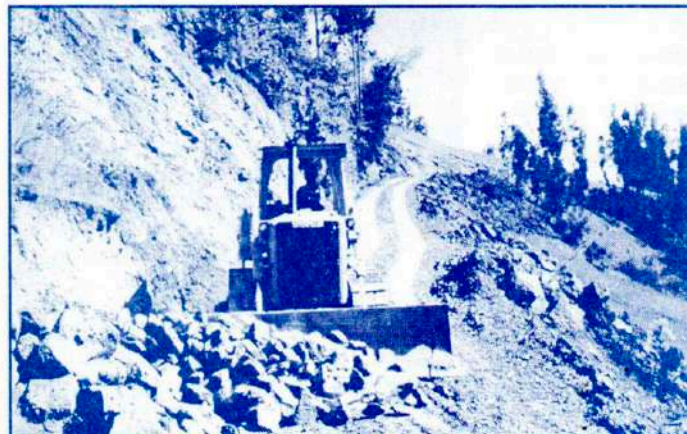
Carretera a Rayán; se prolongó hasta las cercanías de Socos Huayá. Se construyó otra hasta Pampash.
